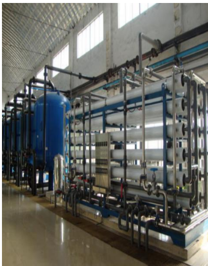
图 1 电厂化学水处理系统
